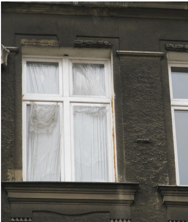
Fot.9 Fragment elewacji – brak elementu sztukatorskiego nad oknem, pierwotne tynki cyklinowane pokryte wtórnie tynkiem nakrapianym, tynkiem nakrapianym pokryto również elementy pierwotnie gładkie
