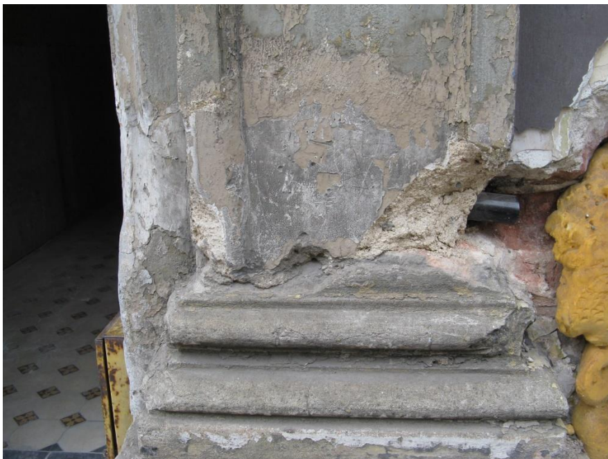
Fot.12 Fragment portalu – uszkodzenia w dolnej partii
