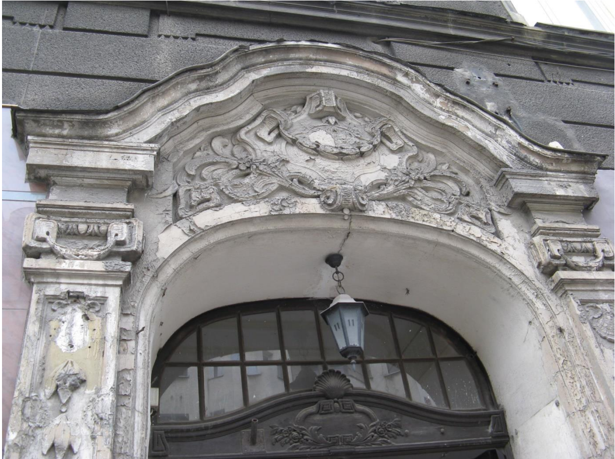
Fot.11 Fragment portalu – czytelne łuszczące się powłoki farb
