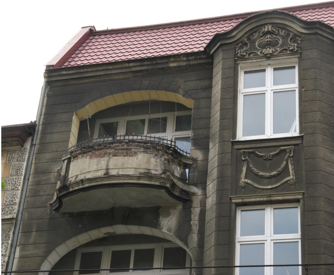
Fot. 7 Fragment elewacji – widoczne uszkodzenia balustrady balkonu
